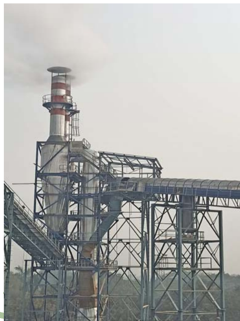
Fig. 2 Actual site photo-Bagasse Drier
